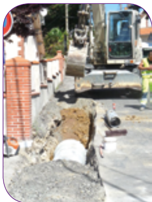
Réseau eaux pluviales
