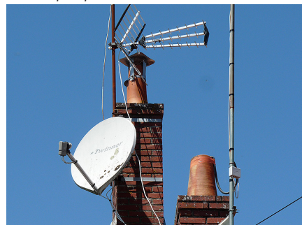
Les antennes et paraboles peuvent dégrader fortement l'esthétique des toitures.
