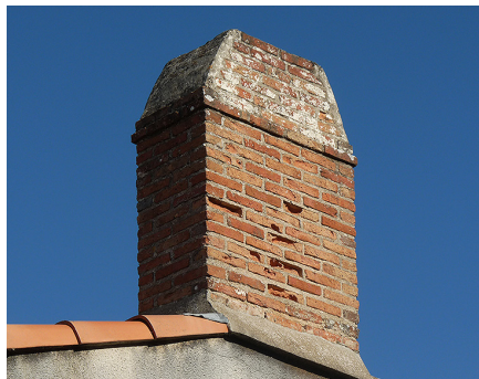
Souche ancienne à couronnement pyramidal. Les briques dégradées doivent être remplacées.
