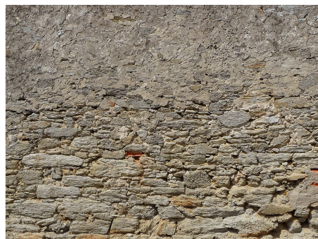
Enduit ancien dégradé par le temps et en cours de disparition progressive : d'un enduit lisse en partie haute, il devient « à pierres vues » puis laisse finalement les moellons à nu et les joints de terre sans protection.
