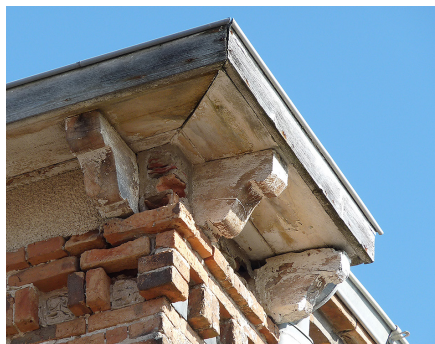
Éléments de charpente, briques et joints de mortier dégradés suite à l'absence d'entretien des zingueries.
