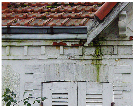
Paroi en pierre enduite à modénature de brique en cours de dégradation par le ruissellement des eaux.
