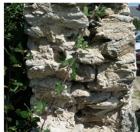
Mur ruiné montrant les parements extérieurs réunis par un « tout-venant » en pierres et terre.
